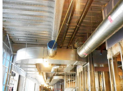
Actual Field Installation
